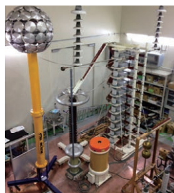
図2 AC・DC・インパルス高電圧試験装置
